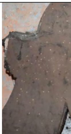
Foto 4. Atac xilofag, depuneri diverse pierderi de material lemnos, fisuri în fibra lemnului
